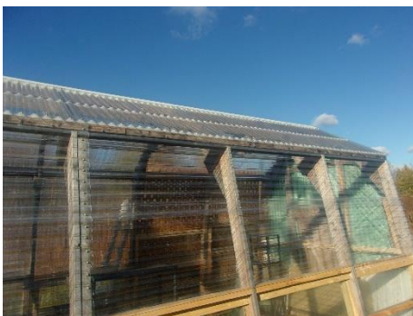
Recouvrement de la serre en verre et plastique, effectué par des bénévoles
