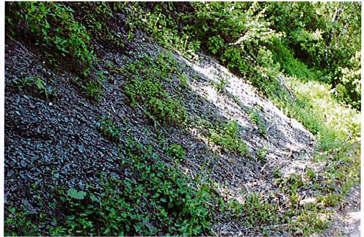
Vue de l'érosion qui descend dans le fossé côté Sud
