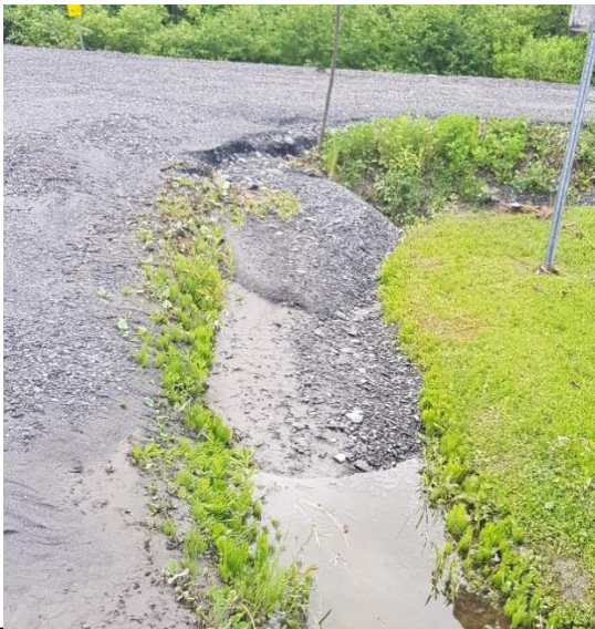
Figure 1.5 État des routes et des fossés après l'orage violent du 18 juin 2018
