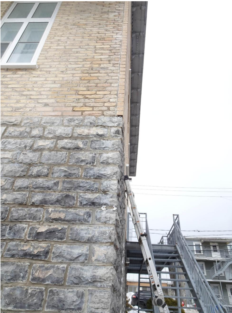
Photo 8 : le mur de brique ne présente aucune déformation.
