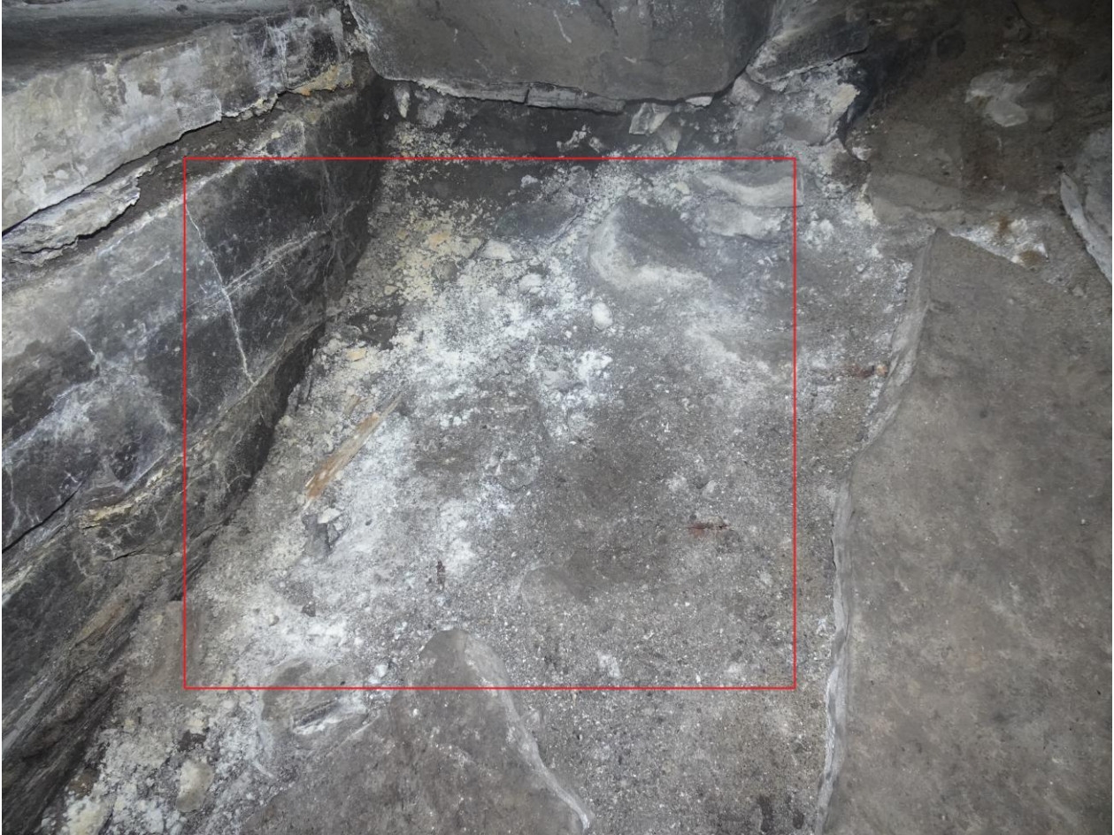
Photo 1 : Traces d'efflorescence (salpêtre), fondations de l'ancien couvent.
