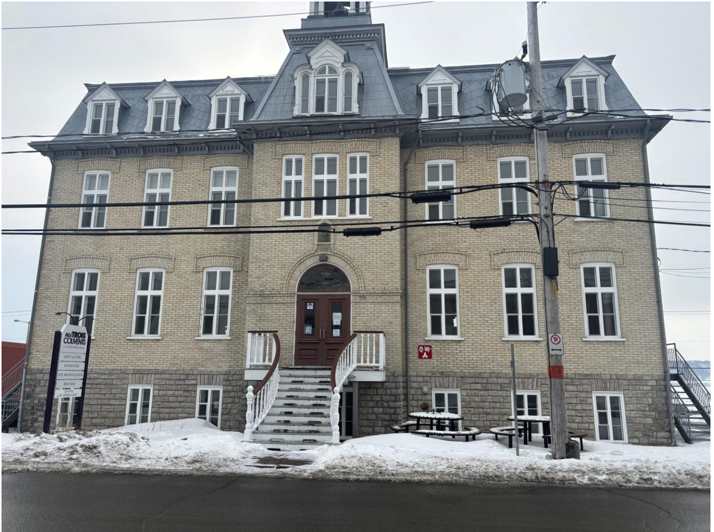
Photo 3 : Façade principale côté Nord les joints du sous-bassement et de la brique sont en bon état.
