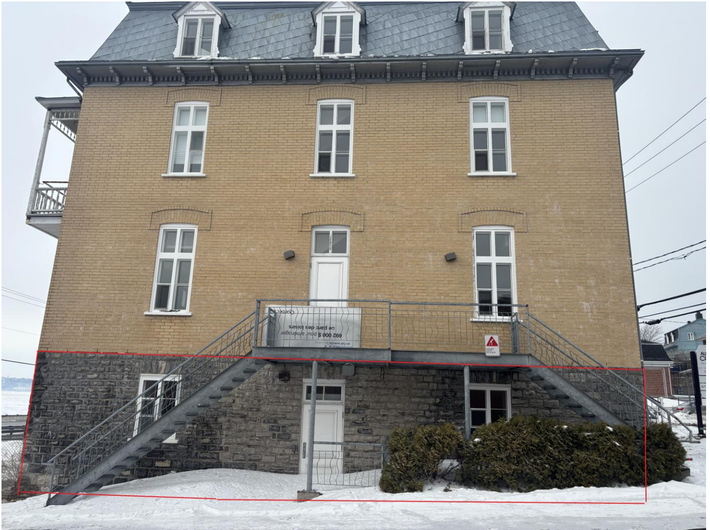
Photo 2 : élévation Est. Les joints du sous-bassement sont à refaire à 100%.
