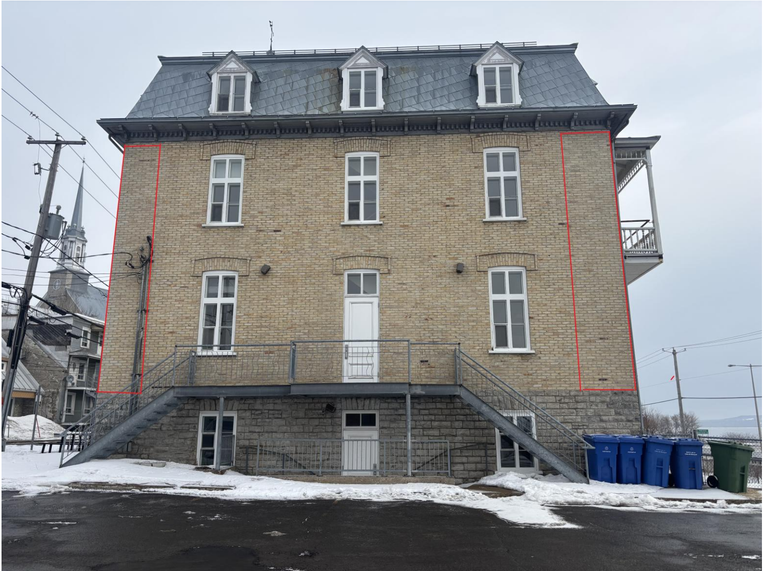
Photo 4 : Façade côté Ouest : 10% des joints de maçonnerie sont à refaire au niveau du sous-bassement.
