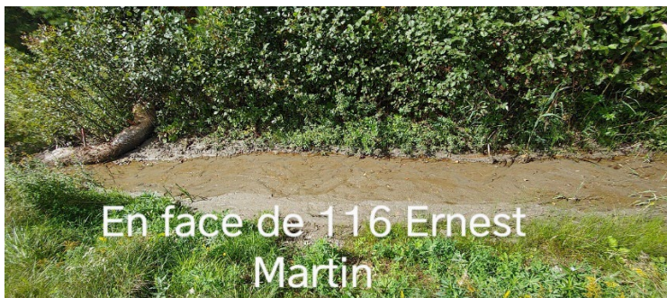
Figure 8 : Fossé ensablé en aval du 118 route 263
