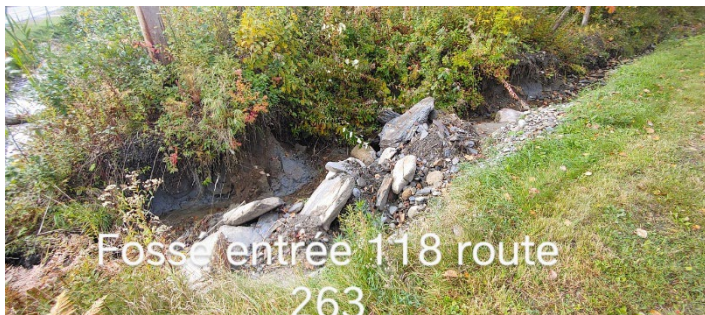
Figure 7 : Traces d'érosion apparente à l'entrée du terrain au 118 route 263
