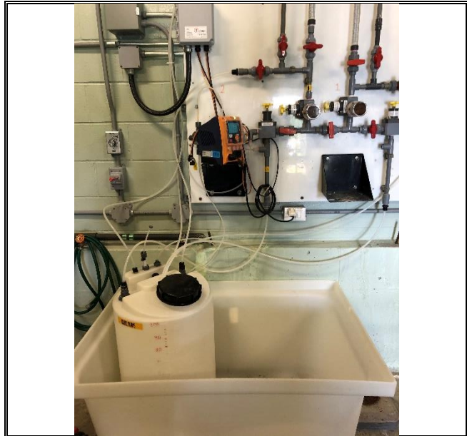
Photo 10 Date 9 juin 2021 Description : Anciens équipements de chloration dans l'installation de distribution. À l'heure actuelle, aucune chloration ne se fait au réservoir.
