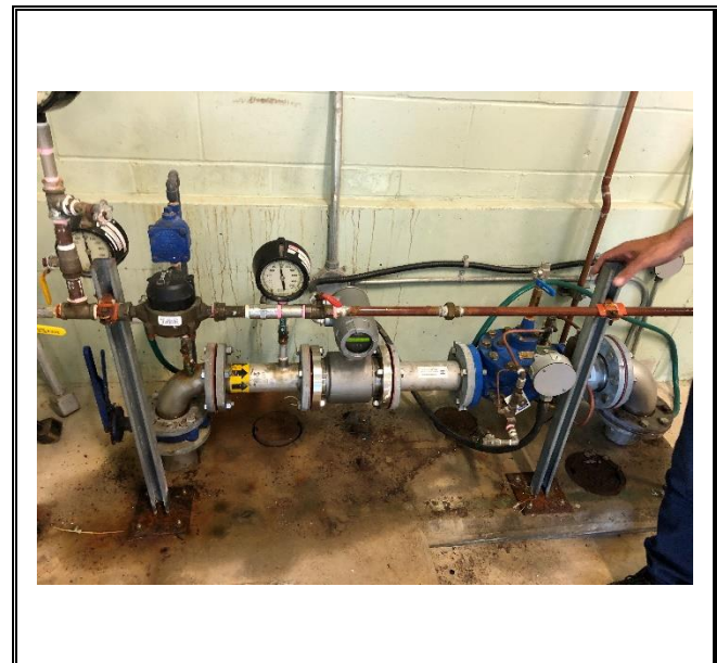
Photo 8 Date : 9 juin 2021 Description : Conduite d'eau traitée arrivant de l'installation de production, se dirigeant au réservoir.
