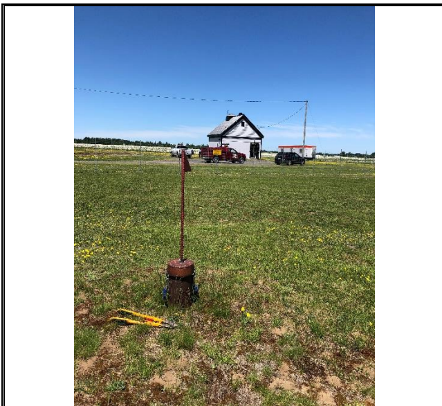
Photo 11 Date 9 juin 2021 Description : Piézomètre SG-6, situé sur le terrain voisin du site du puits municipal SG-7.
