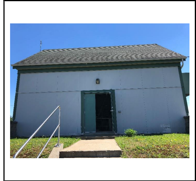
Photo 6 Date 9 juin 2021 Description : Vue d'ensemble de l'installation de distribution Saint-Gilles n° X2064347
